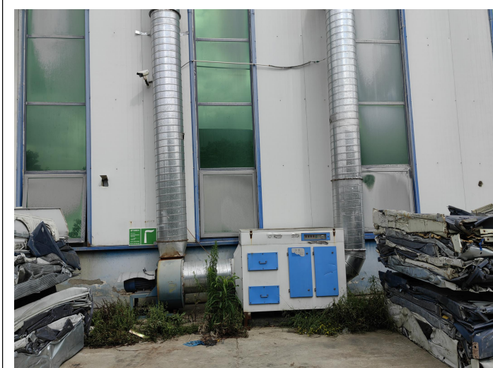
现有工程废气处理设施（光氧+活性炭）
