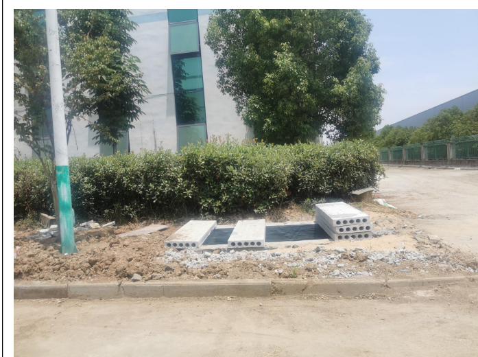
现有工程事故废水收集池
