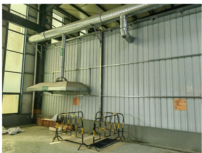
现有工程废气收集设施
