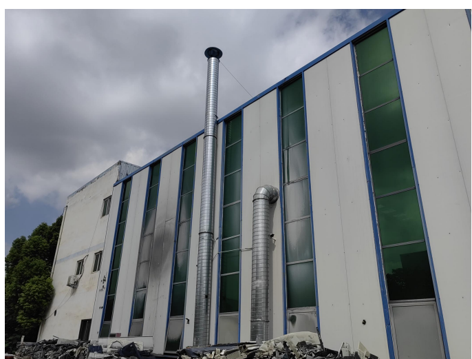
现有工程排气筒
